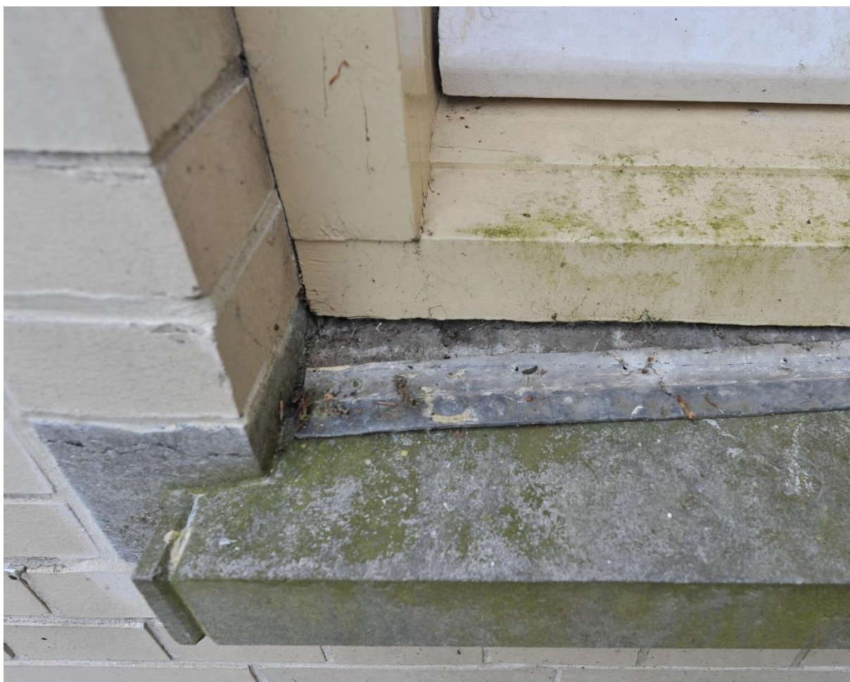
In bovenstaand voorbeeld is de loodslabbe tussen kozijndorpel en stenen weldorpel te smal en bevestigd met (inmiddels roestende ) spijkers. Bevestiging met latten had een beter resultaat geleverd.
